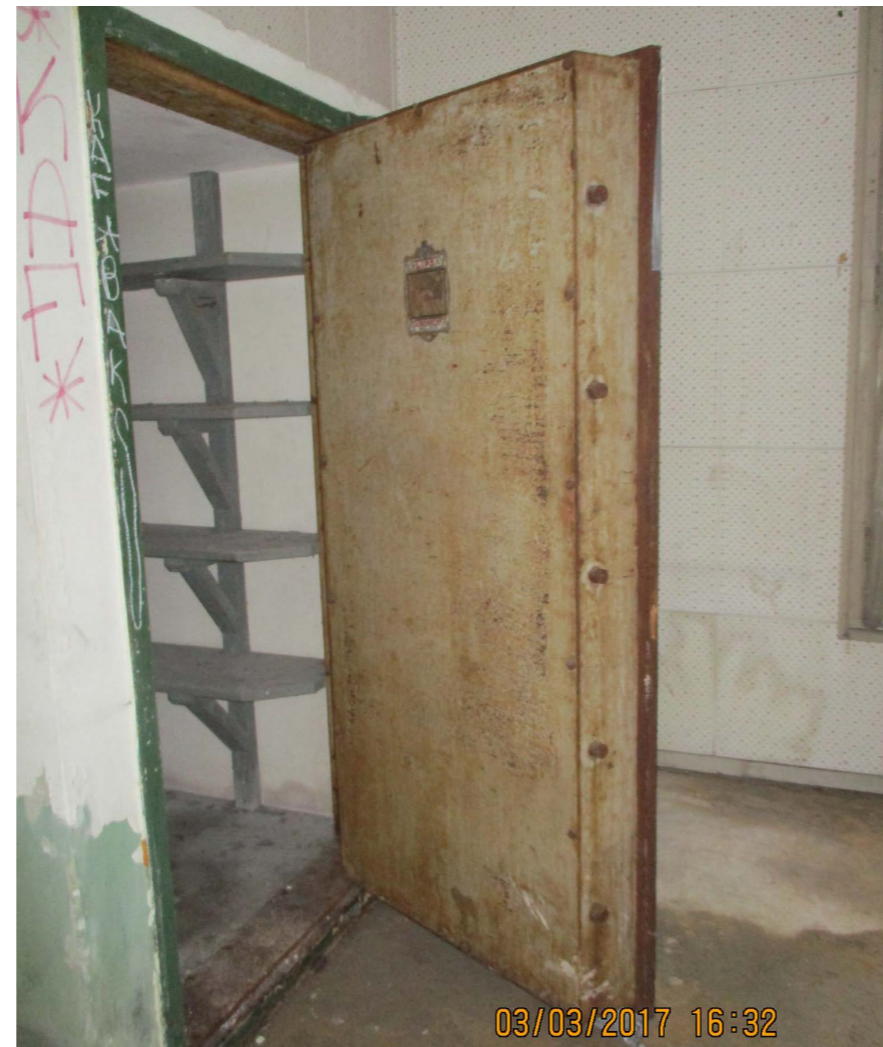
Afbeelding 5.4.40: De ingebouwde Lips-kluis op de begane grond
