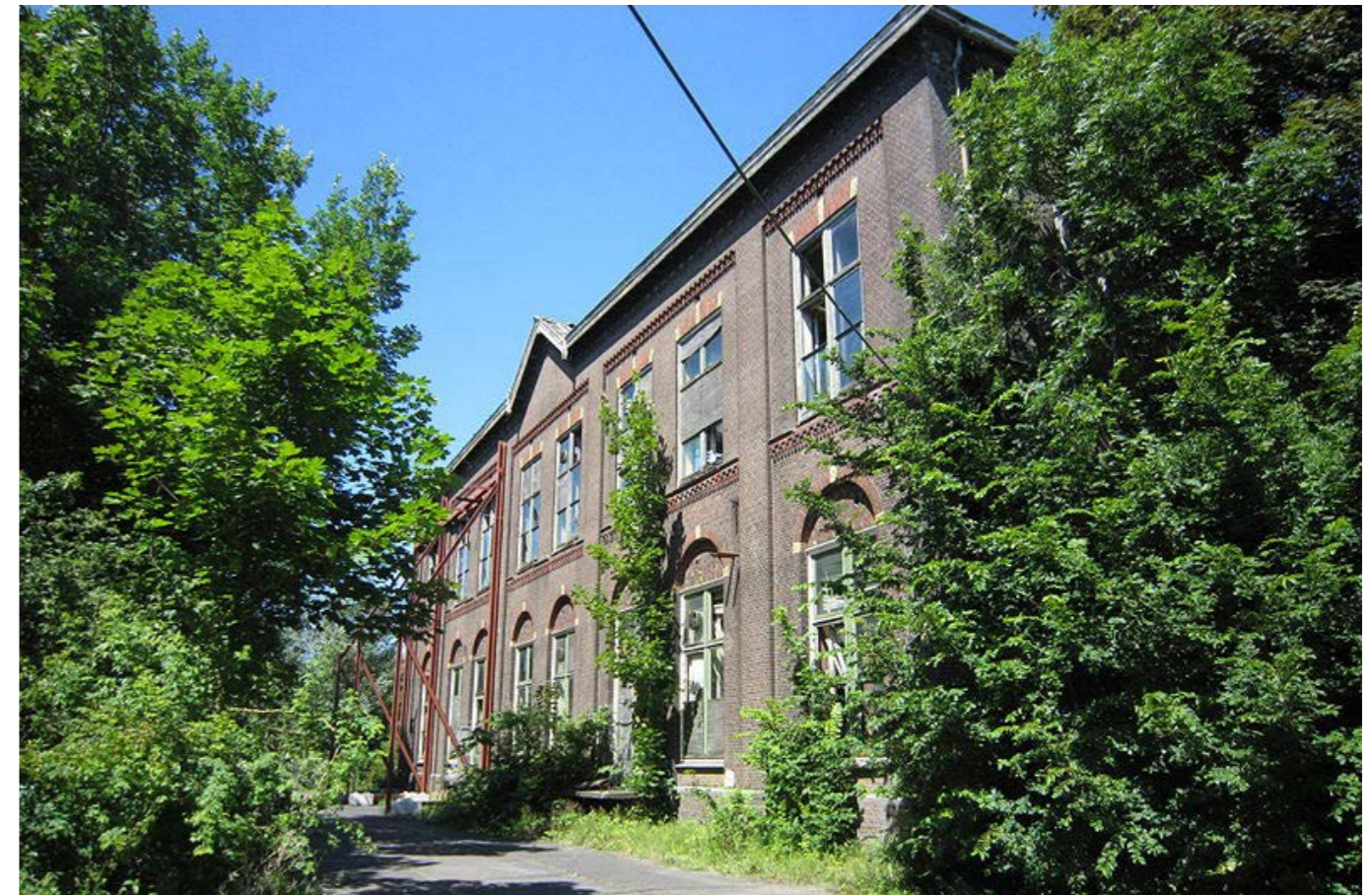
Afbeelding 5.4.47: Noordgevel voor de restauratie werkzaamheden. In de afbeelding is zichtbaar dat de linkerzijde van de gevel is gestut t.b.v. instortingsgevaar. In de kozijnen is het meeste glas verdwenen.
