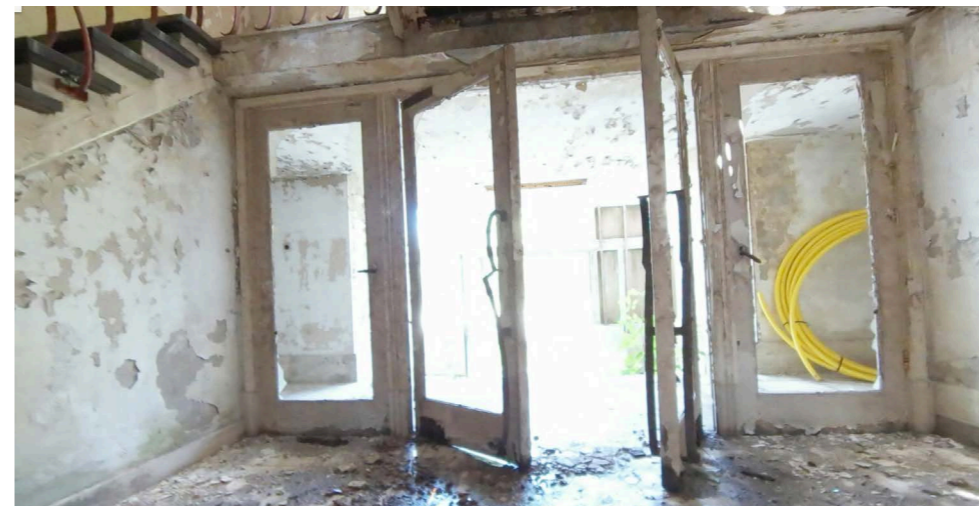
Afbeelding 5.4.51: Het voorportaal is voorzien van vier deuren met als in het midden een dubbel dichtslaan deuren. Aan de kier tussen de deuren gaat het hier om taats deuren. Deze deuren zijn voorzien van stalen handgrepen die dezelfde vorm bevatte als de balustrades.
