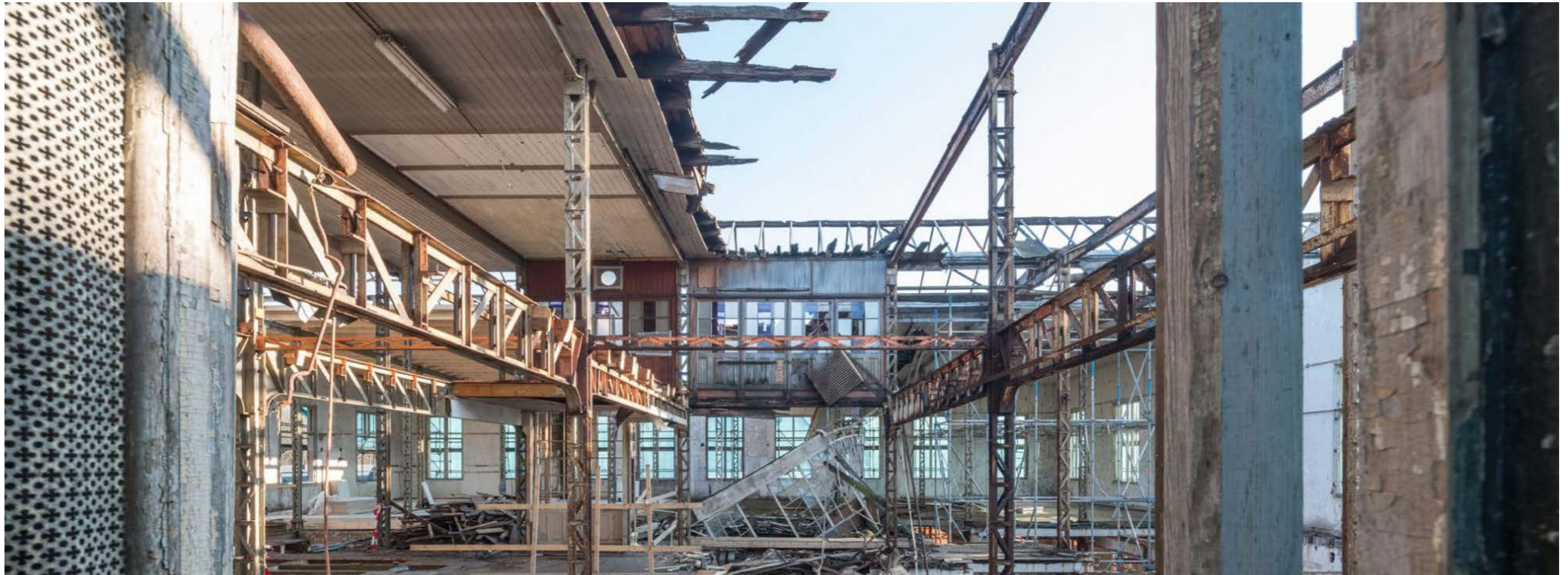
Afbeelding 5.4.53: De afbeelding is gericht op de lichtstraat die gecentreerd is in het midden van het bouwwerk. In de afbeelding is zichtbaar dat een deel van het dak ontbreekt. Hoogstwaarschijnlijk is de balklaag poreus geworden en uiteindelijk doorgezakt. Wat in eerste instantie opvalt links in de afbeelding is het overmaatse kozijnhout met daarnaast de aftimmering ( roosters ) van het gevelkozijn. wat opvalt is dat tussen de 1e verdieping en het plafond in de jaren 50 waarschijnlijk een split level is aangebracht. Zichtbaar is dat er een vakwerkconstructie tussen de bestaande kolommen is aangebracht waarop vanuit hout vervaardigde wanden zijn getimmerd. In het midden van de afbeelding is een pui zichtbaar die uit roedes bestaat. Het lijkt erop dat tijdens de verbouwing omstreeks 1938 van een opslag van wapenen tot kantoor functie de open ruimtes die een forse vrije hoogte bevatten te delen.
