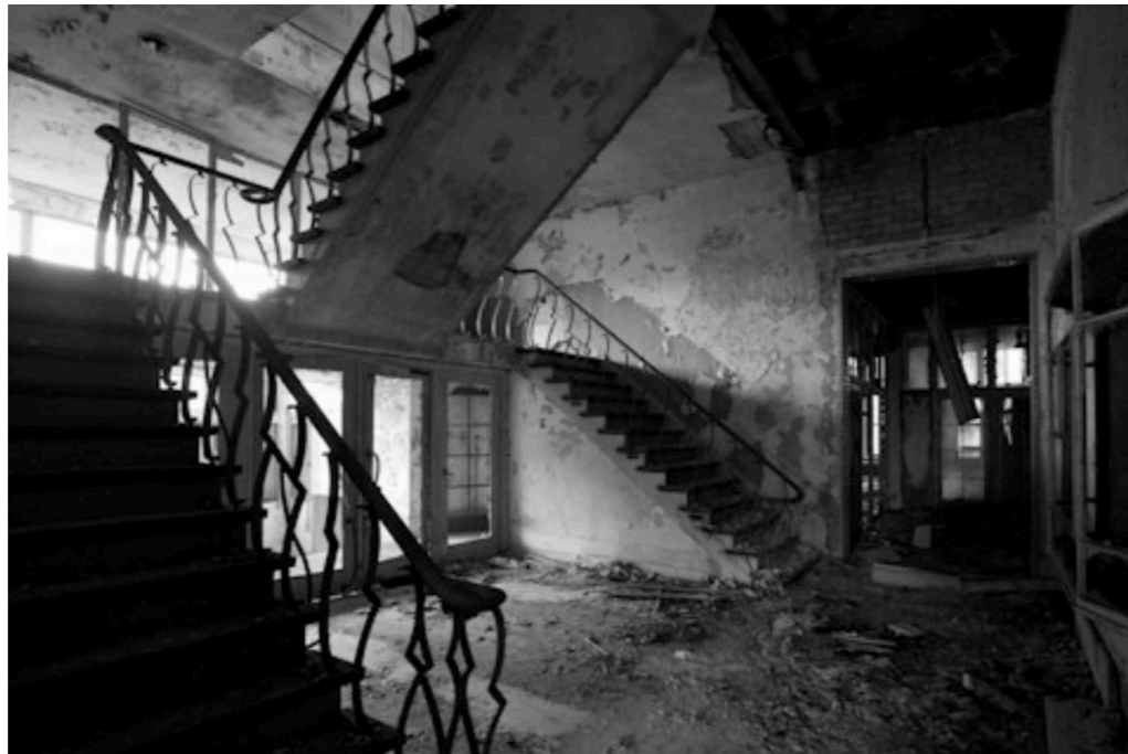
Afbeelding 5.4.49: Zichtbaar in de afbeelding is het voorportaal dat afgesloten word door een royale entree deur. Rechts is in de afbeelding lijkt het zo te zijn dat er een soort van receptie, servicebalie heeft gezeten. In de sparing van de muur is nog een gedeeltelijk van een scheiding zichtbaar van een ruimte-afscheiding. Deze afscheiding bestaat uit een lichtvenster opgedeeld in vierkant vorige patronen die wellicht afgestemd zijn op de deurstijlen. Deze wand bevind zich hoogstwaarschijnlijk op de constructie as.
