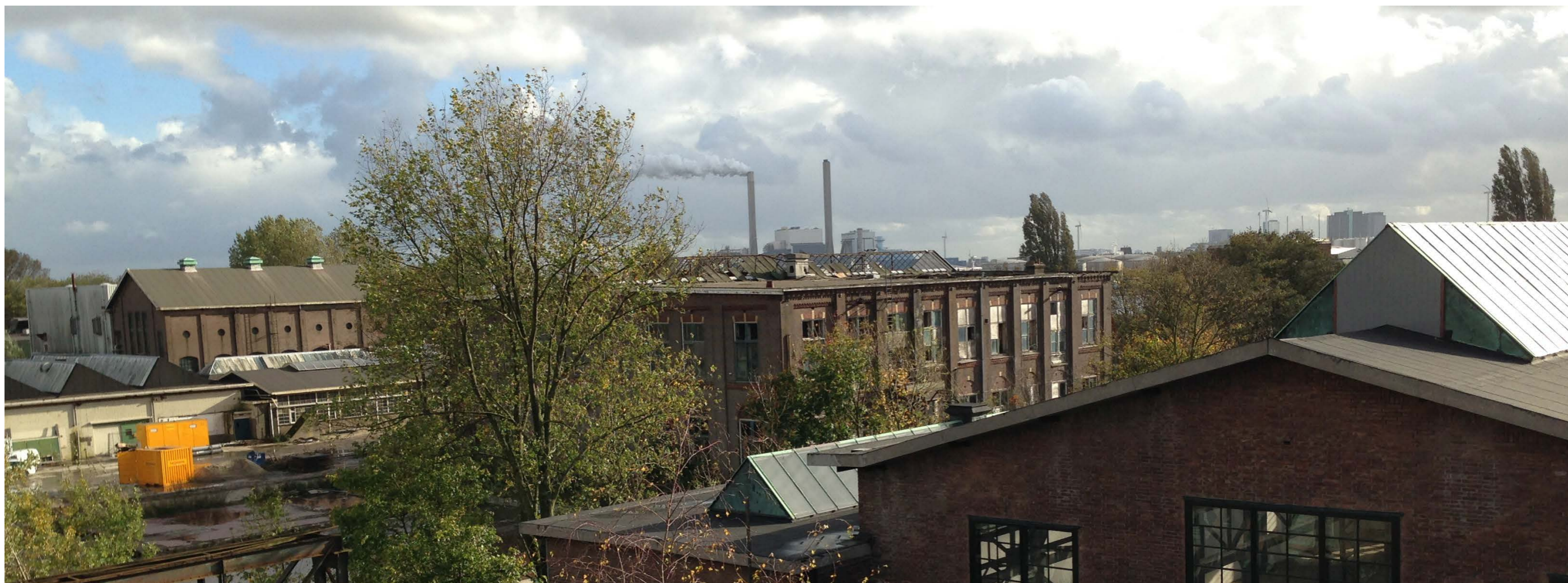
Afbeelding 5.4.52: De afbeelding is gericht op het waterfront. Zichtbaar is dat het dak van gebouw 8 deels open is. Zoals Kees Benschop vertelt is dat er een deel van het dak is ingestort. Ook is zichtbaar dat naast de lichtstraat een schoorsteen is gesitueerd. De lichtstraat is niet meer bruikbaar en nog van enkel voorzien van een x aantal glasplaten.
